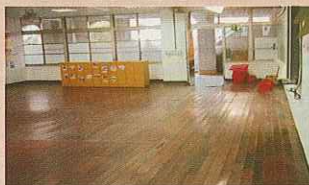
教室原破損木質地面
